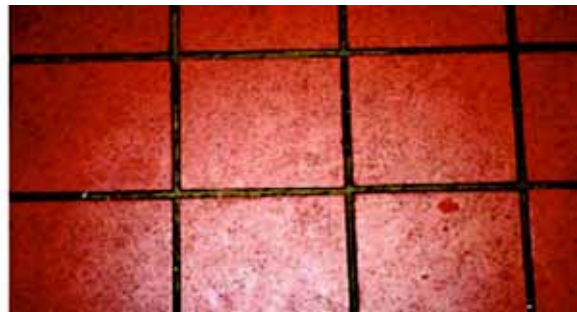
Fugenmasse in den Küchenfliesen hellen bei der Verwendung von Chrisal allmählich auf
