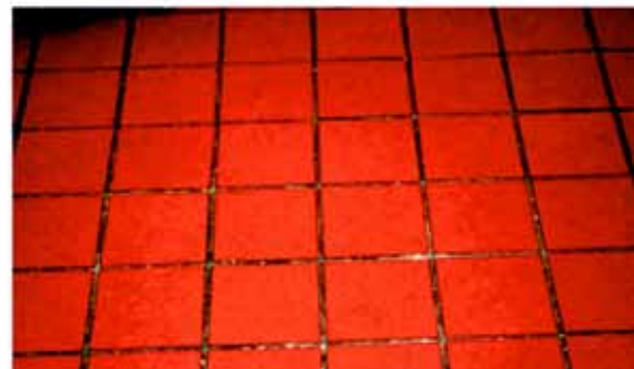
Aufhellung von Fugenmasse und Fliesen nimmt mit der Verwendung von PIP zu.
